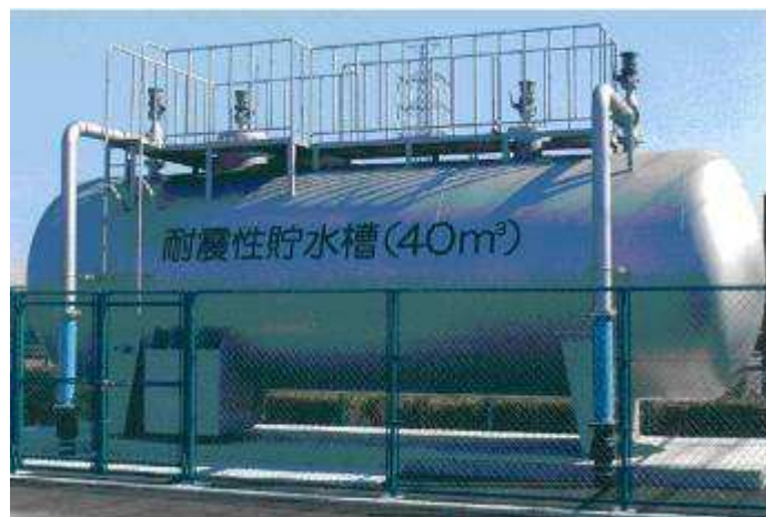
■ 地上式耐震性貯水槽の例
