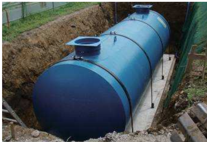
■ 地下式耐震性貯水槽の例
