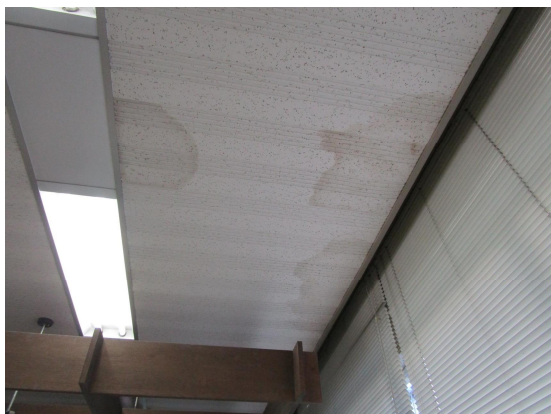
雨漏りによる天井のシミ
