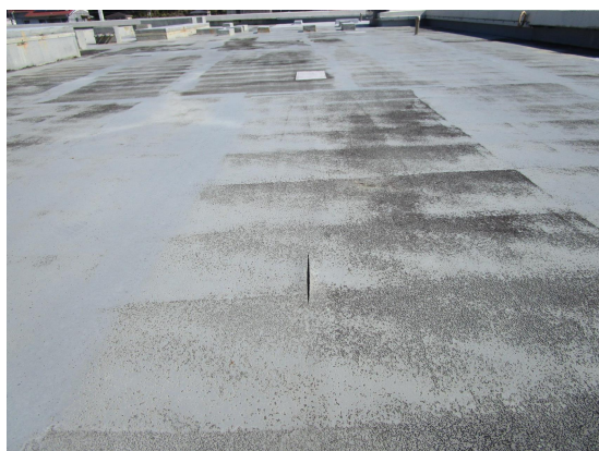
屋上防水層の破損
