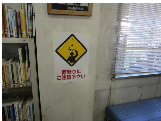
雨漏りの注意喚起
