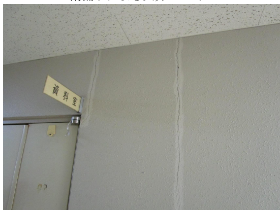
壁のクラック
