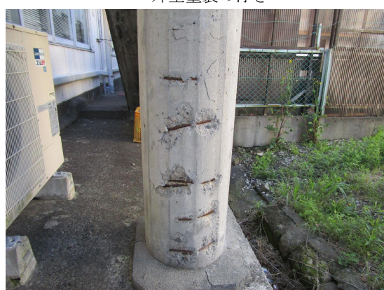
外階段のコンクリート剥離
