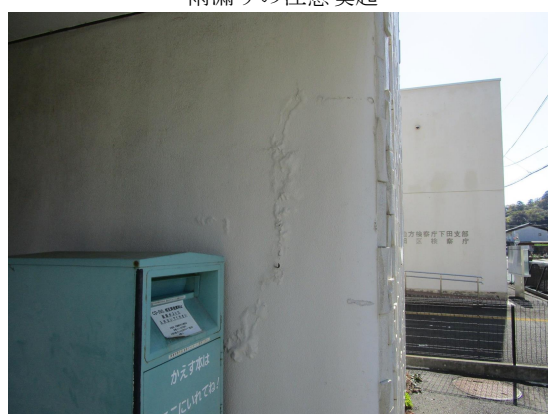
外壁塗装の浮き
