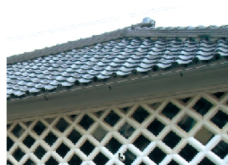
修繕前の壁面。瓦部分（黒い壁）は建設当時のもので、劣化が進んでいました
